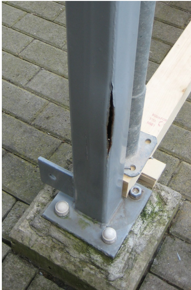
Figuur A.6 — Verticale scheur op de hoek van een kokerkolom als gevolg van bevriezing van water in de kolom
