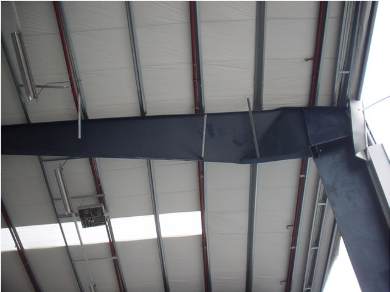
Figuur A.3 — Uitgeknikte ongesteunde binnenhoek van een spantconstructie
